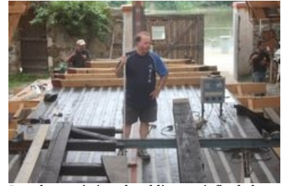
La sole terminée et le tablier posé, fin de la première étape de notre chantier, une pause bien méritée pour notre photographe Pascal.
