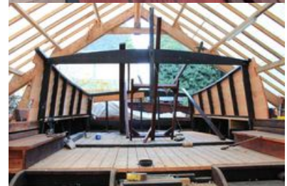
Novembre 2016: nouvelle étape, la construction de la cabane de protection de la motorisation
