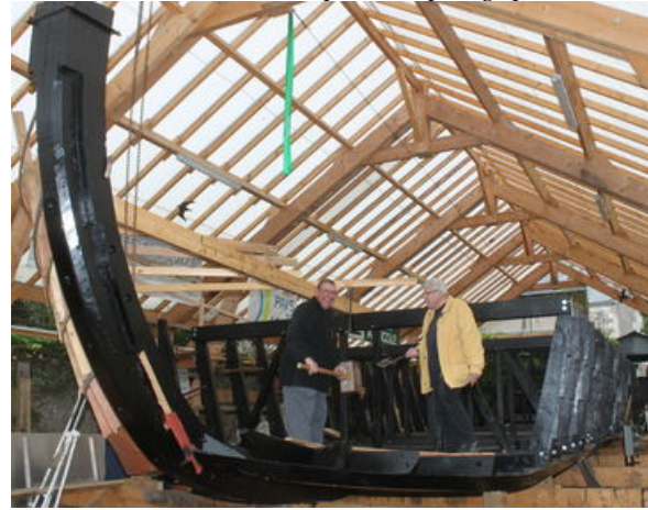
Jean Yves, notre chef de chantier en causerie de Loire avec Jacques
